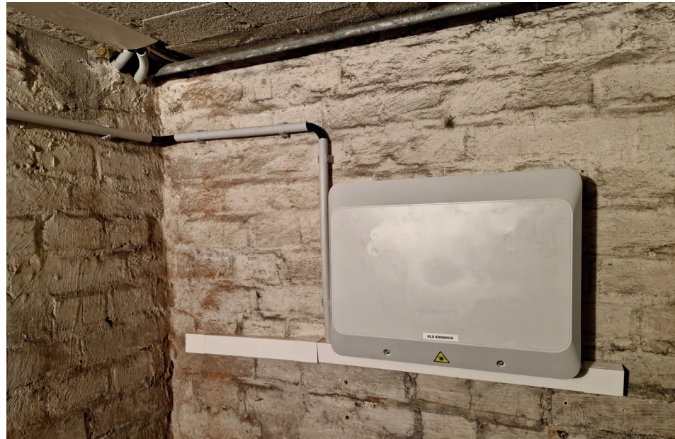
Gebäudeverteiler im Keller im Dichterviertel
