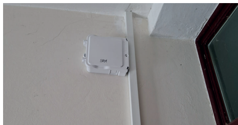
Etagenverteiler im Treppenhaus
